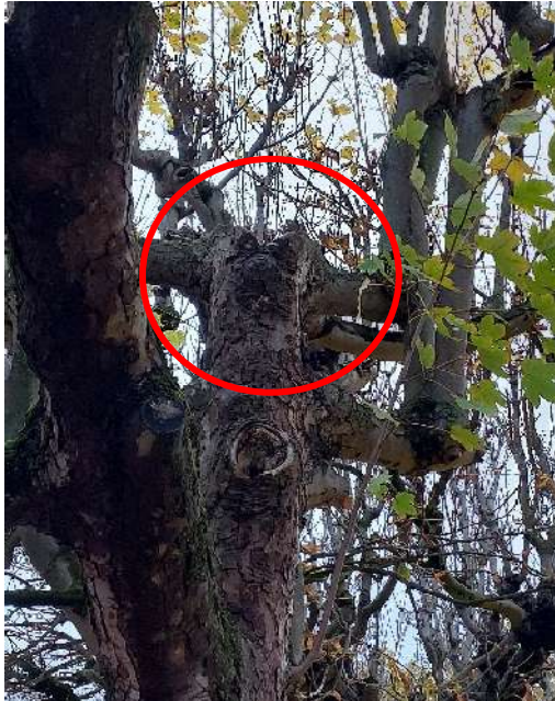
Erable n°78 : charpentièrre centrale anciennement r duite et creuse en t te
