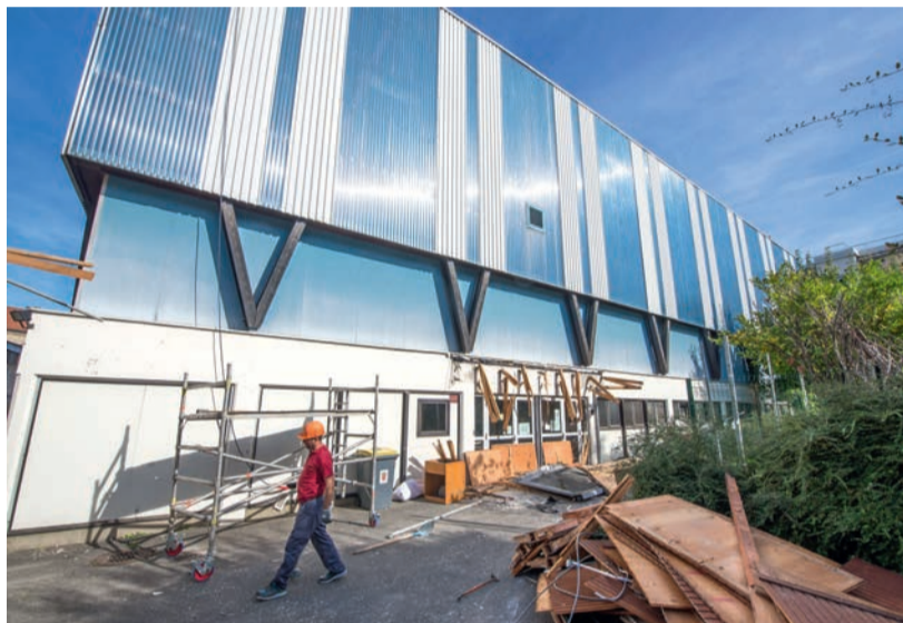
Réhabilitation du gymnase Jean-Bouin, qui sera suivie de la construction d'un second gymnase : Jean-Bouin II.
