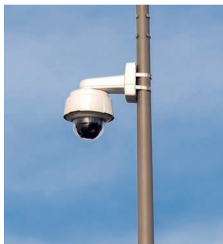
Aux caméras installées à la gare depuis sa rénovation s'ajoutera la vidéoprotection, mise en œuvre dans la ville, en 2019.
